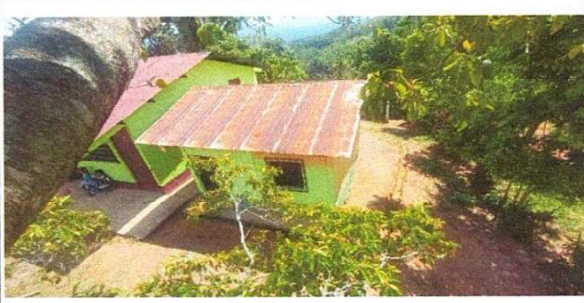
Foto 4: sustitucion de lanimas de la cocina cpmo se en la fotografia esta dañado.
